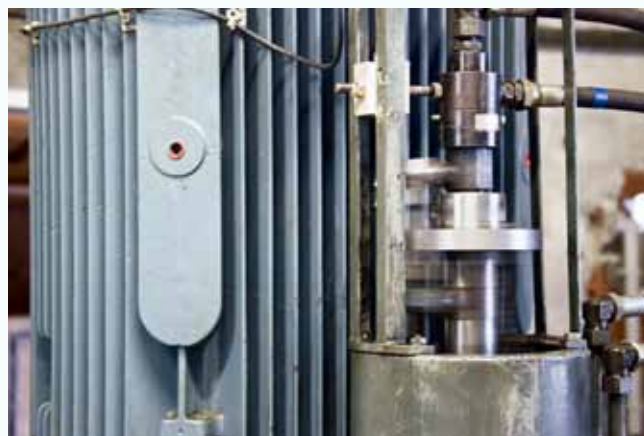
Generator und Hydraulikaggregat der Kaplan-Turbine des Kraftwerks Lempdes
