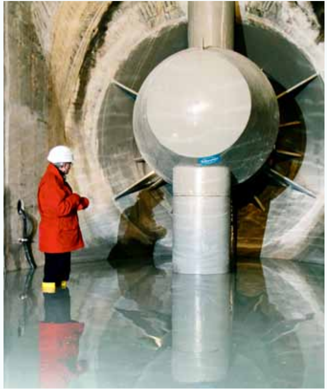
Blick auf die 30 Tonnen schwere Kaplan-Rohr-Turbine vor der Flutung im Juni 2010
