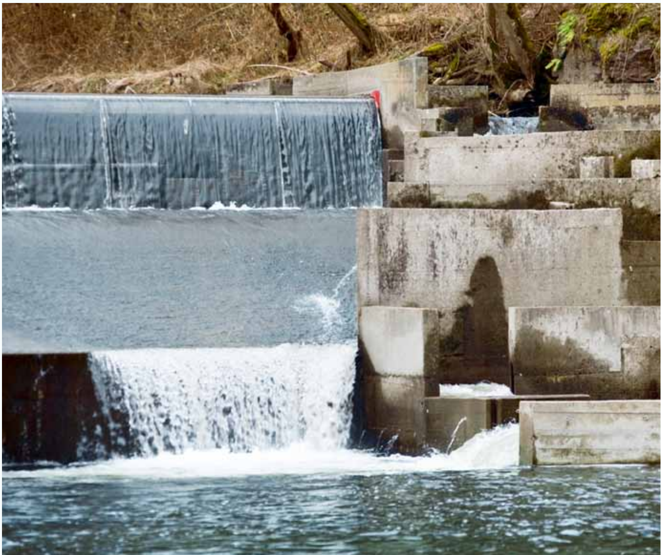
Wehr und Fischaufstiegsanlage des Kraftwerks Lempdes
